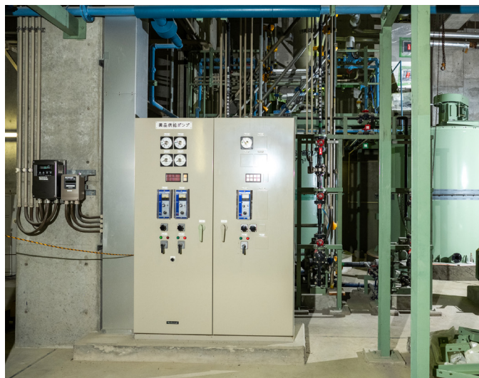
大杉さんがメンテナンスに携わった下水処理施設の薬品供給設備。下水道事業においても官民連携は欠かせない。
