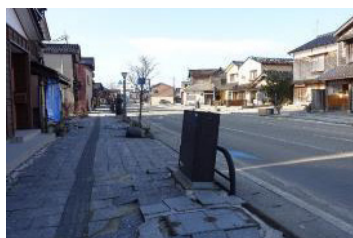
車両通行に支障となる被害はない 地上機の傾き、特殊部周辺の沈下を確認
