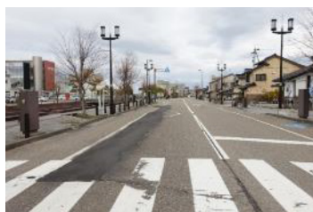
車両通行に支障となる被害はない 段差は応急復旧済み
