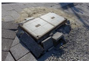
液状化により、特殊部の周辺が沈下したと思われる
