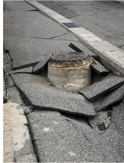
【写真-2 液状化により浮上した下水道のマンホール】 (輪島市：令和6年3月著者撮影)
