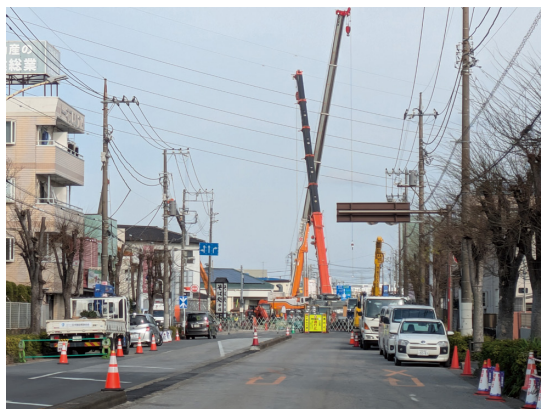
【写真-2：八潮市の道路陥没現場では今も復旧作業が続いている（2025年4月5日筆者撮影）】
