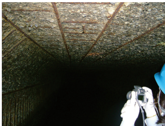
【写真-1：都内某所の下水管の内部。下水管表面のコンクリートは腐食でなくなり、内部の骨材や鉄筋がむき出しになっていた（右端は筆者）】
