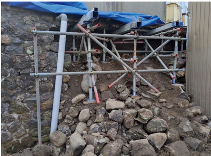
【写真-1 金沢市内の空石積擁壁の崩壊状況】
