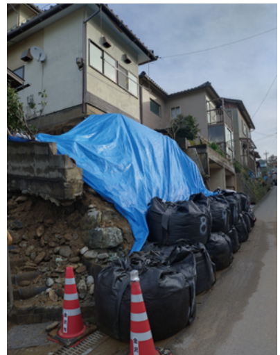
【写真-2 金沢市内の増積擁壁の崩壊状況】
