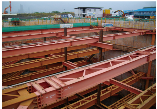
写真-6 トンネル換気口内の切梁支保
