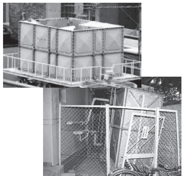
写真-2 給水設備(水槽)の被災例
