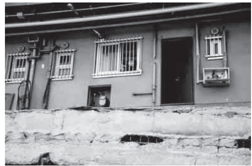
写真-4 共同廊下の被災例
