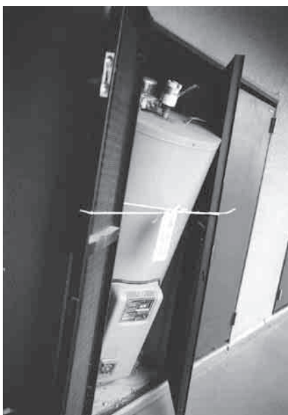
写真-1 建築設備の被災例
