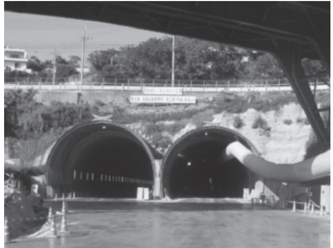
図表4 無導坑方式で施工中的那覇空港自動車道豊見城トンネル
